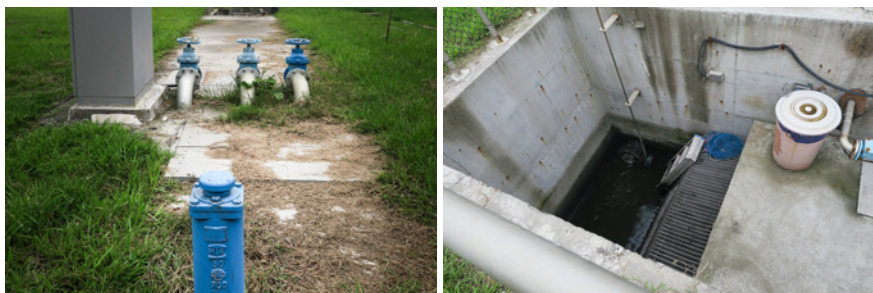
左・進水控制閥／張雅雲攝 右・污水經攔污及沉砂後再泵送至後方的進流渠道／張雅雲攝
