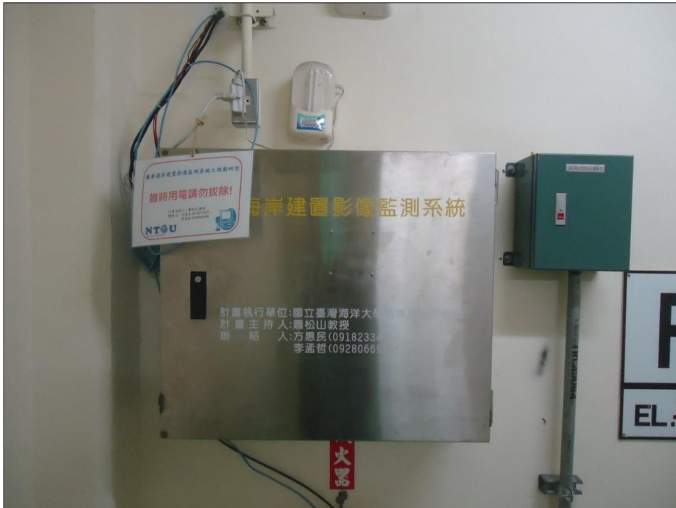
圖 3-17 觀測站主機機箱
