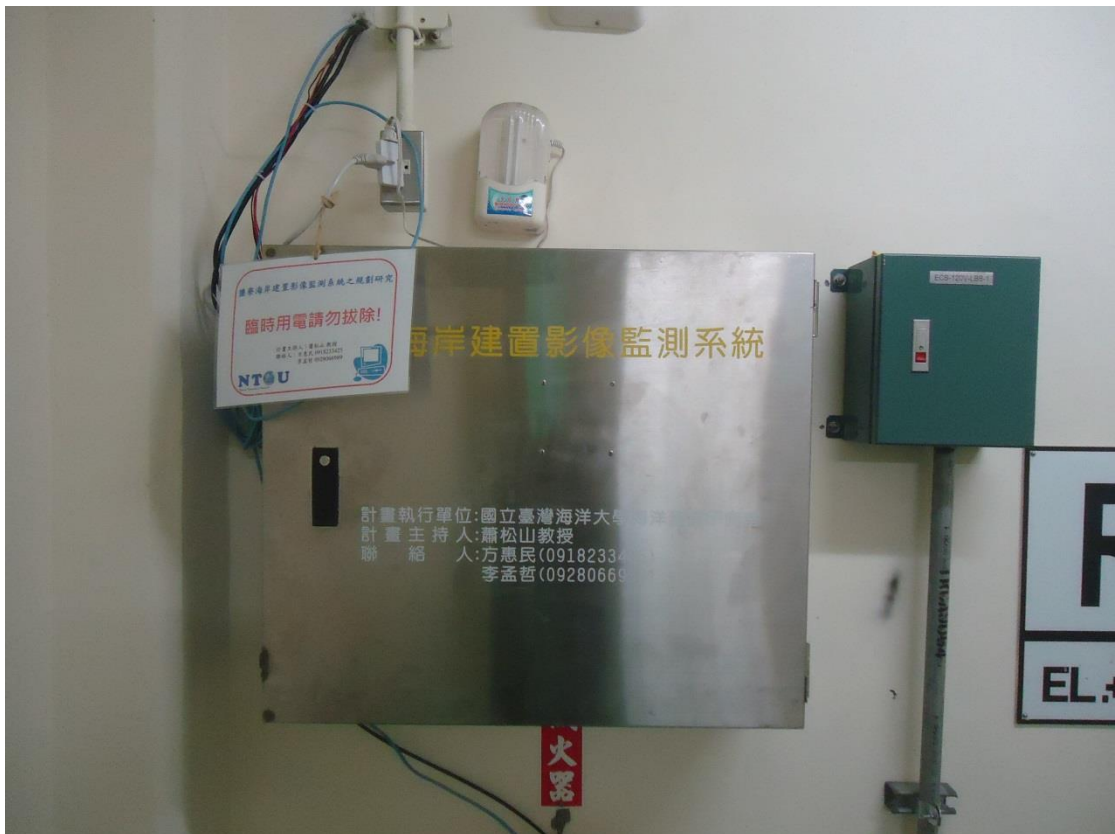
圖 3-17 觀測站主機機箱
