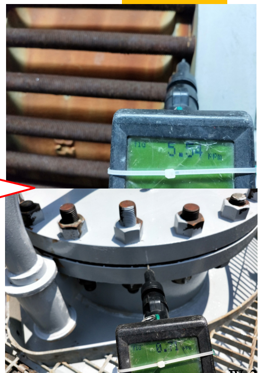
洩漏法蘭已利用 歲修期間更新墊 圈，檢修後複測 已無洩漏
