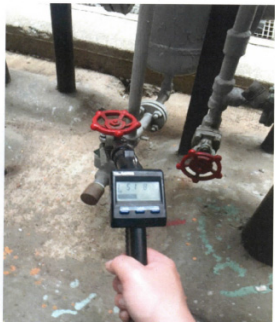
排放管 BV 格蘭加鎖，複測值 5.18ppm
