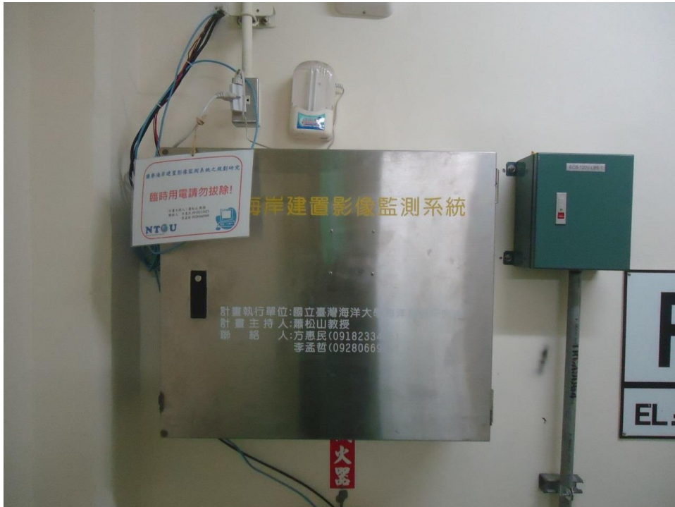
圖 3-15 觀測站主機機箱
