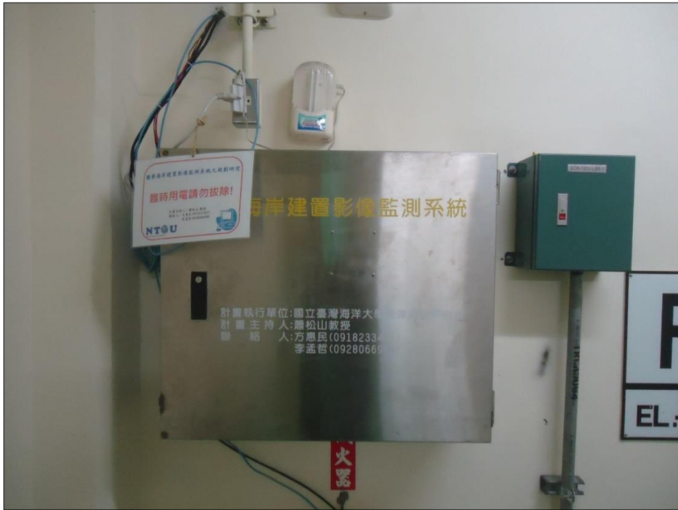
圖 3-17 觀測站主機機箱
