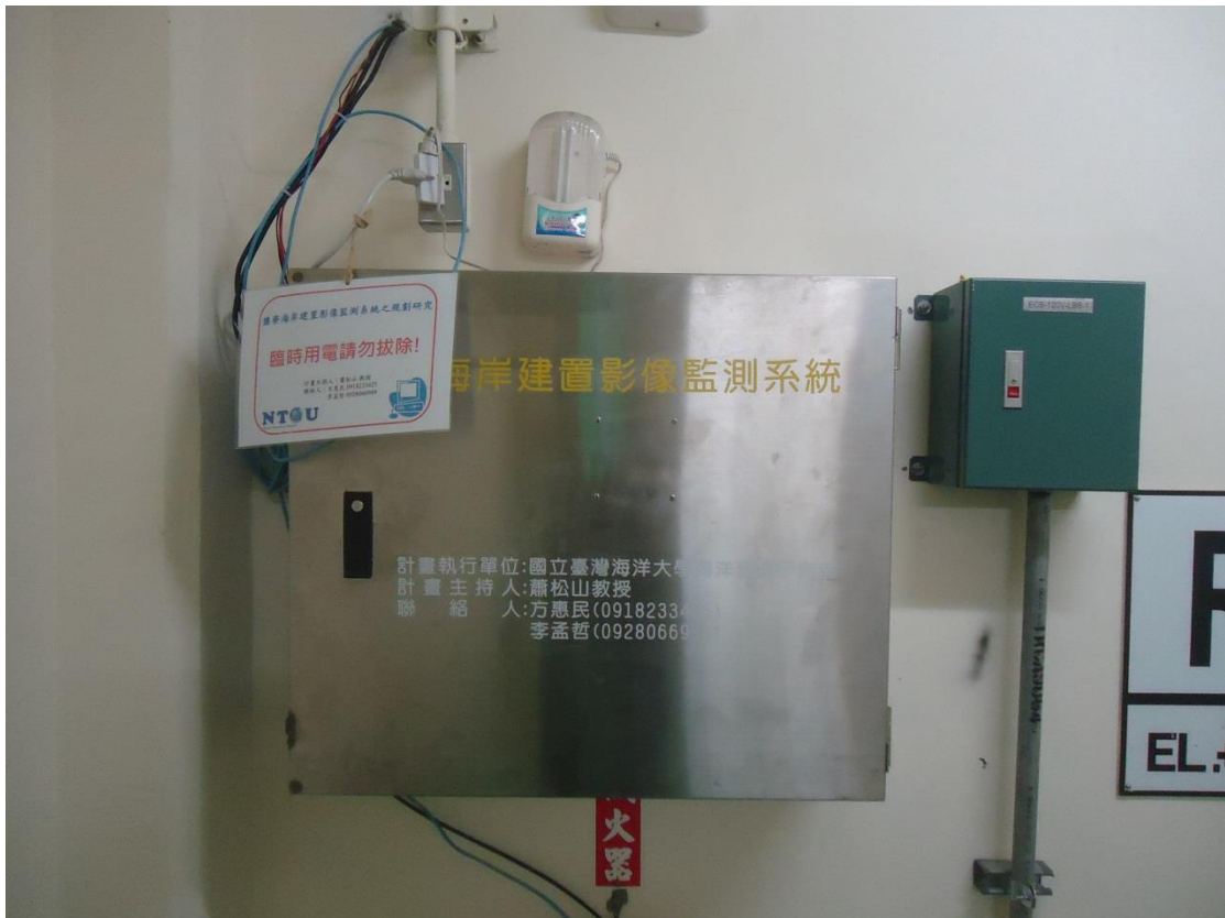
圖 3-15 觀測站主機機箱
