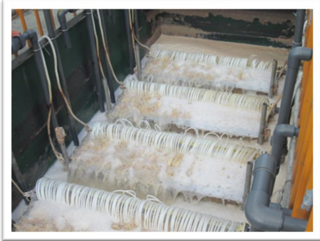
增設薄膜生物處理設備 提升廢水處理效能
