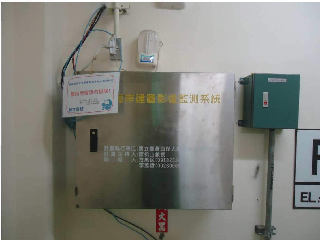
圖 3-14 觀測站主機機箱
