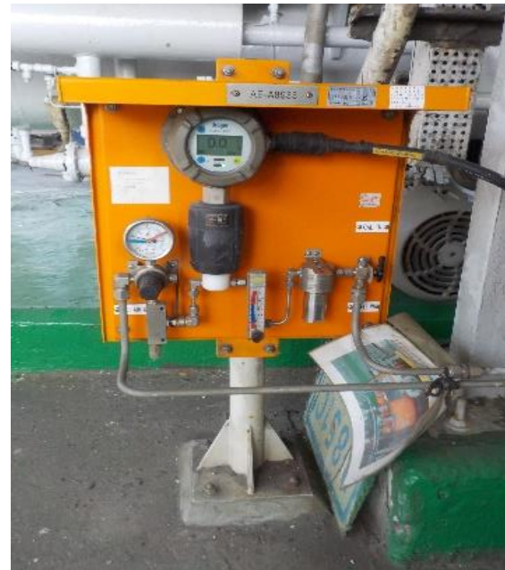
液氨區域設置氨氣偵測器 (塑化碼槽處案例)
