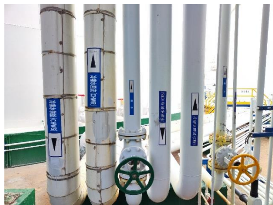
廢水以管線密閉方式輸送 (塑化廢水場案例)
