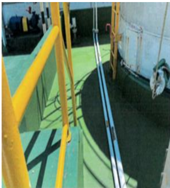
液氮儲槽防液堤 (台塑碳纖廠案例)
