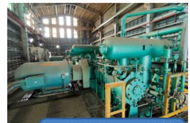
既有往復式壓縮機廢氣回收系統
