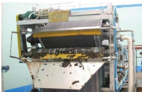
(現有)帶濾式污泥脫水機
