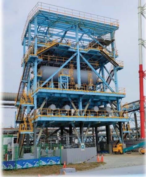
北區廢氣回收系統工程照片
