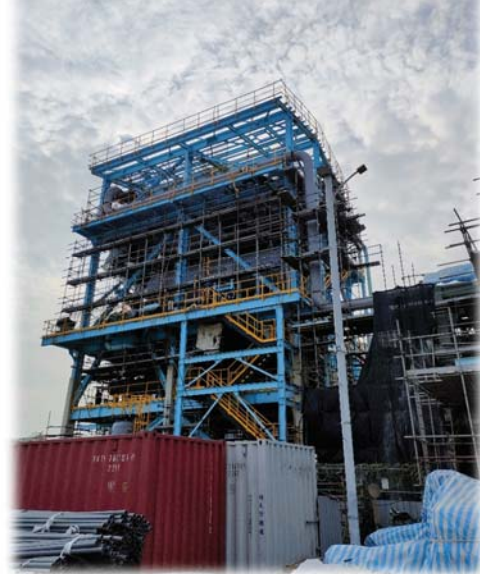
南區廢氣回收系統工程照片
