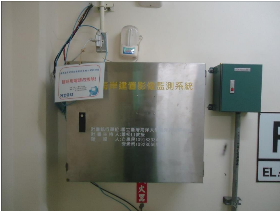
圖 3-17 觀測站主機機箱
