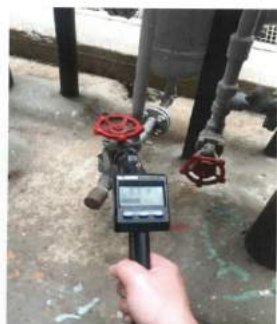
排放管 BV 格蘭加鎖，複測值 5.18ppm
