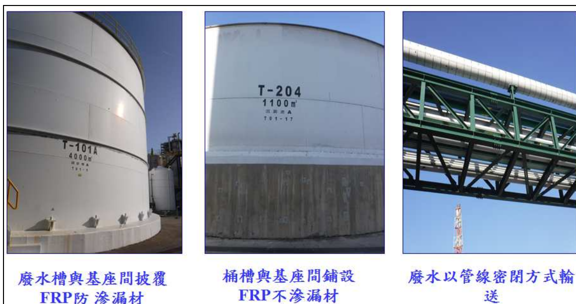
附圖二、長春集團麥察廠區廢水廠防止溢流措施
