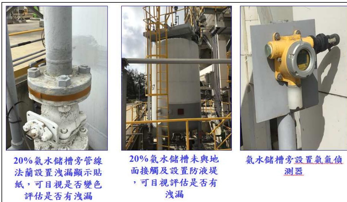
附圖一、長春集團麥察廠區氨水儲槽污染防制措施
